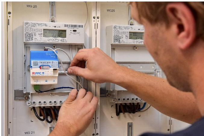
Installation eines Gateways in der Wohnanlage in Hermsdorf. Foto: Stadtwerke Jena/Jürgen Scheere
